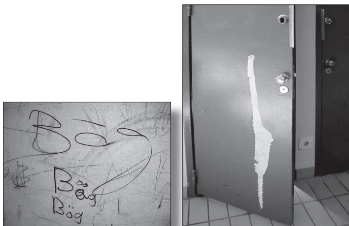
Bild 16: Klotter och skadegörelse
