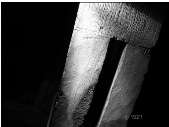
E – Bjælke indvendigt. Taphul fra SB (se bilag I-6-F)
