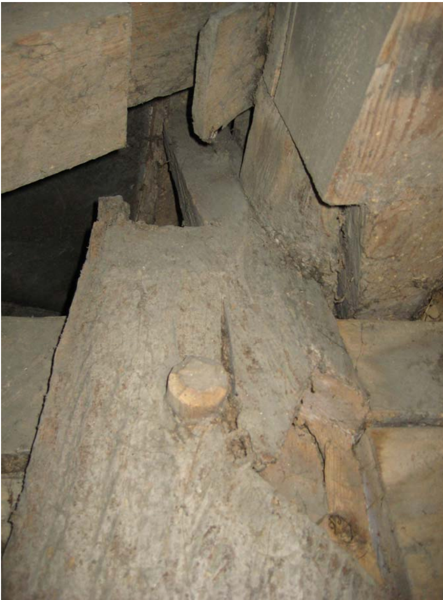
Fig. 8. Stav 1. Detaljbilde av knekt stavtopp og innfelling til skråband C Foto S.N. Feb 08.
