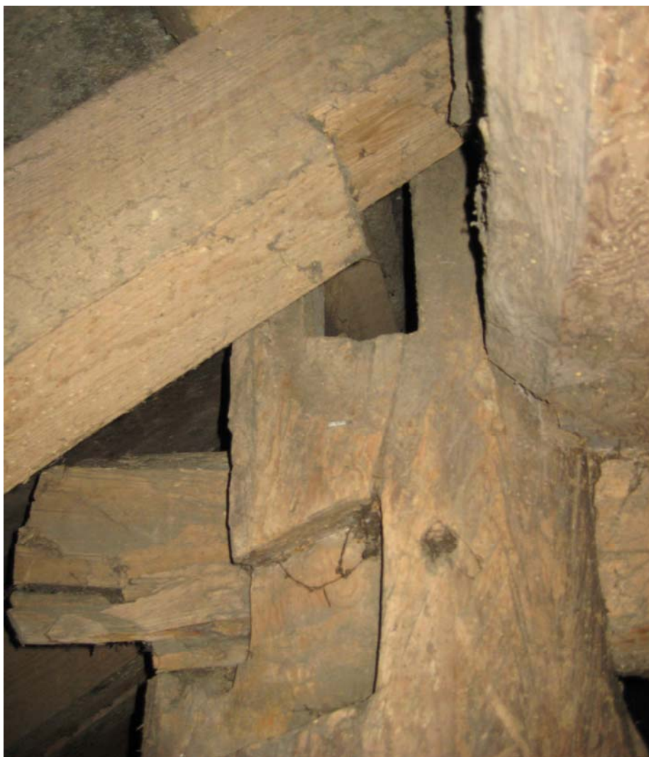
Fig. 9. Stav 2 detaljbilde av stavører og skråbandhakk C. Foto S.N. Feb 08.
