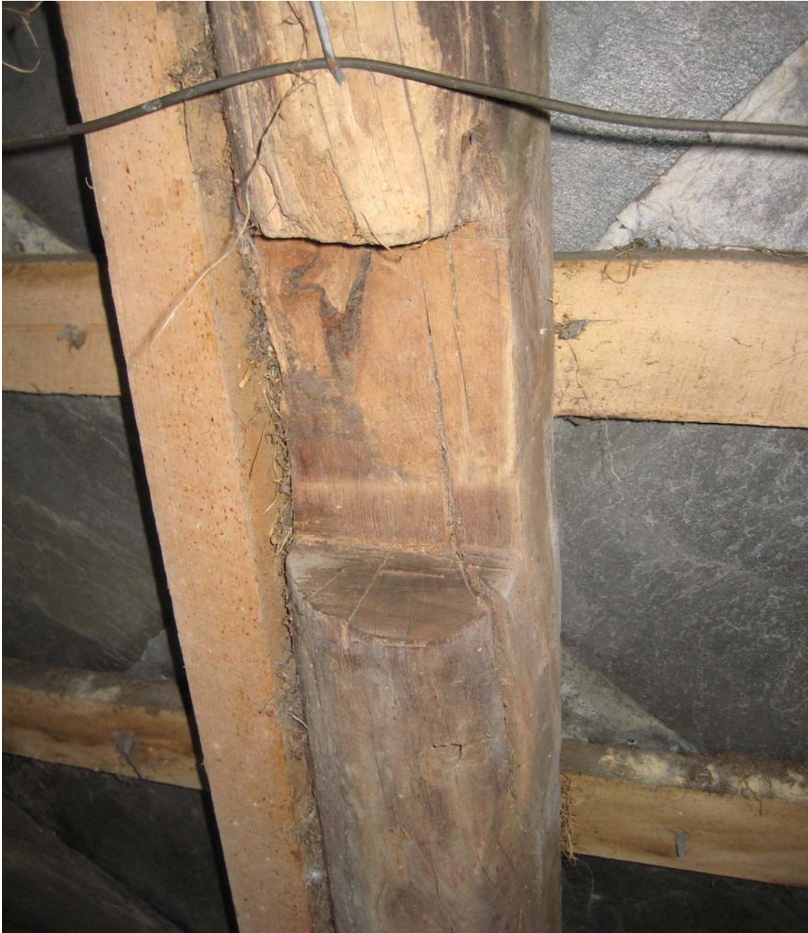
Fig. 33. Sperre. I hakkets bunn ses et markert skille fra stavlegja, samt delt øksehogg fra materialtørking. Det bekrefter at hakket er tatt ut mens sperra var rå.
