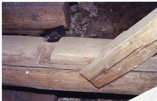
Spåret efter klockor som har varit upphängda i en bindbjälke i Gökhem, i långhusets nordvästra del, foto C. Thelin 2005.
