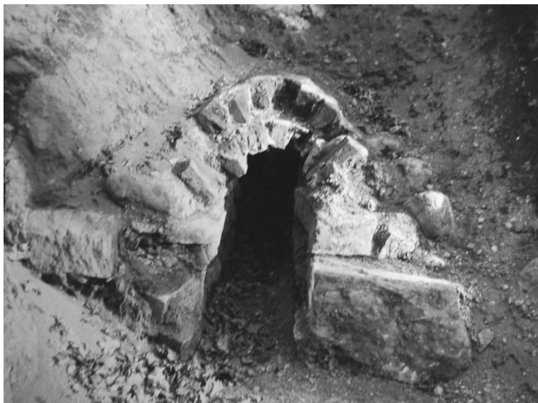
Illustration 8: Mynningen av kloakledning som har kunnat användas som flyktgång. Foto: Harald Olsson.
