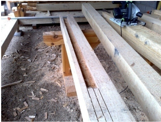
Figur 20 Sågade spår i stolpen
