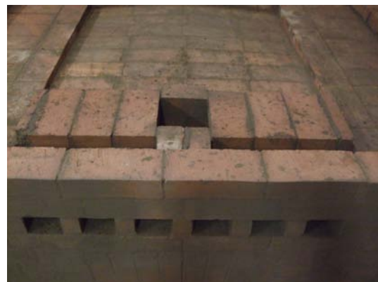
Figur 43. Rökkanalens tak med rökutsläpp.
