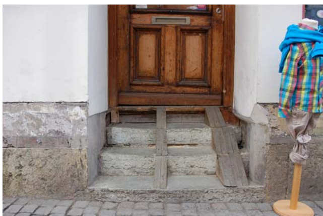
Ill. 6. En annan entré på Vallgatan 21 har kulturhistoriska egenskaper i form av ursprunglig entrédörr (B), med karm (D) samt trappsteg (C).
