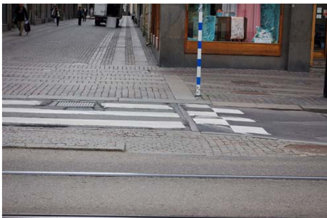
Ill. 12. Övergångsstället Vallgatan – Västra Hamngatan saknar kontrastmarkeringar och har många ojämnheter i markbeläggningen.
