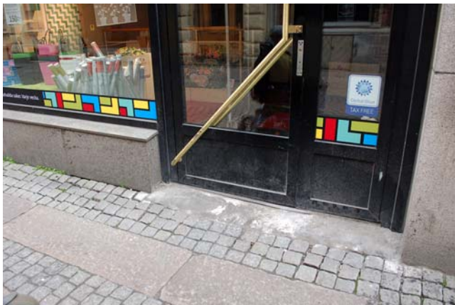
Ill. 19. Den gjutna betongkanten i liv med fasad är alltför brant, dörren skulle behöva en automatisk dörröppnare. Vallgatan 14
