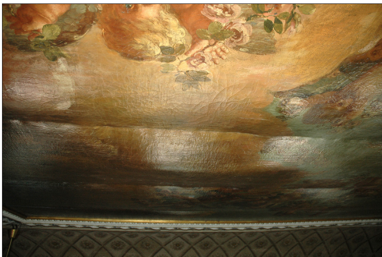
Fig. 11. Våderna slackar kraftigt på grund av generella depositioner av grus och puts från ovsidan. Foto: Jessika Envall
