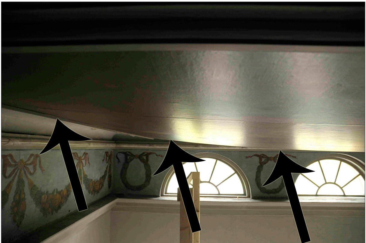
Fig. 6. Duken saknar uppfästning annat än vid ramen längs med ytterkanterna och slackar därför kraftigt i mittpartiet.
