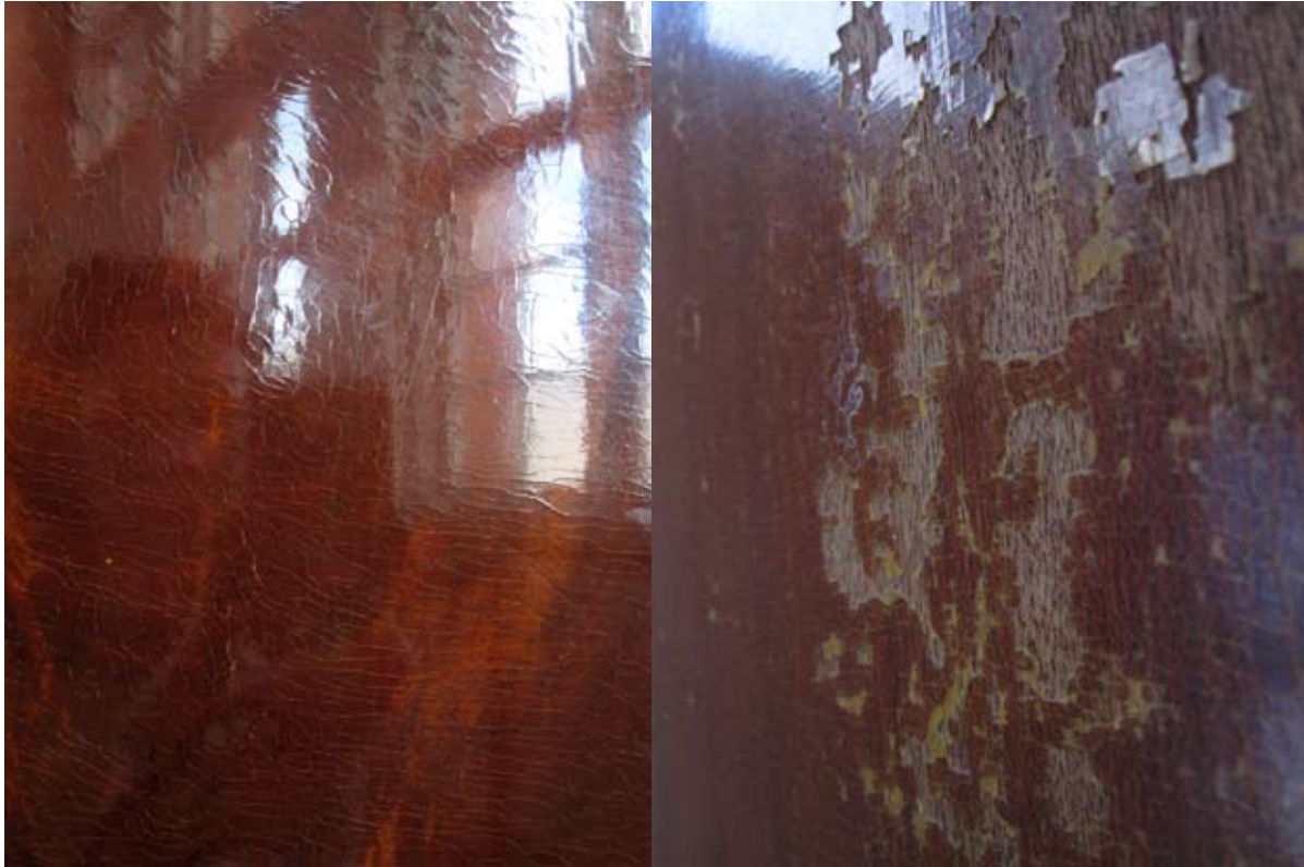
Skåpet var i dåligt skick med lack som krackelerat och flagnat på flera ställen.
