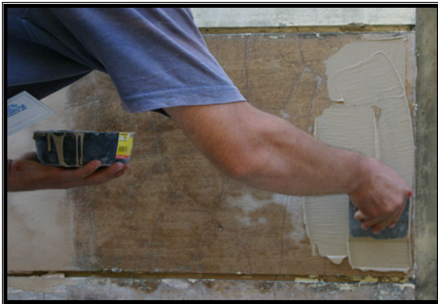
Applicering av ”cement-slurry” på en naturcementfasad i Krakow. De för materialet typiska krympsprickorna är synliga på det obehandlade materialet. 244
