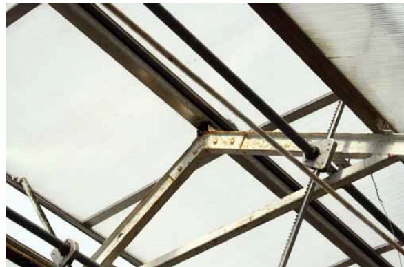
Ill. 26. Det större växthuset. Ventilationsanordning.
