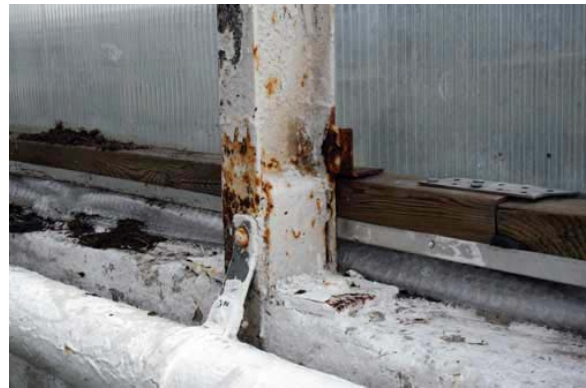
Ill. 25. Rost på takstolsben, det äldre växthuset.
