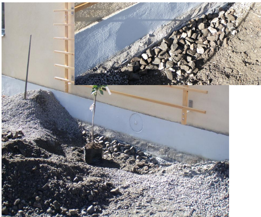
Fig.90 och 91. Körsbäret är placerat i gropen för att kontrollera gropens djup. Större stenkross är lagd ovanpå dräneringsmattan för att underlätta vattenavrinningen.
