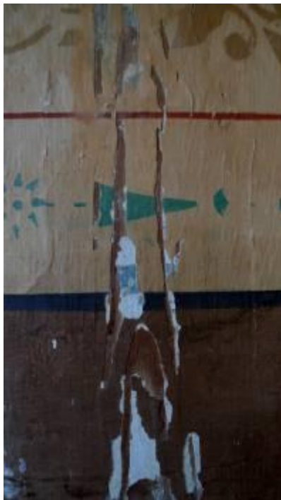
Figur 12. Bortfallen följer till största delen träets fiberriktning. Här är även det understa målningslagret synligt.
