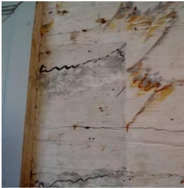
Figur 4. Det underliggande marmoreringsmåleriet framträder på en yta där det förmodligen har suttit ett elskåp.
