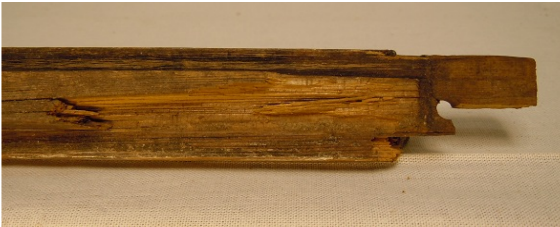
Figur 55 Skadad nacke och spröjsstapp.
