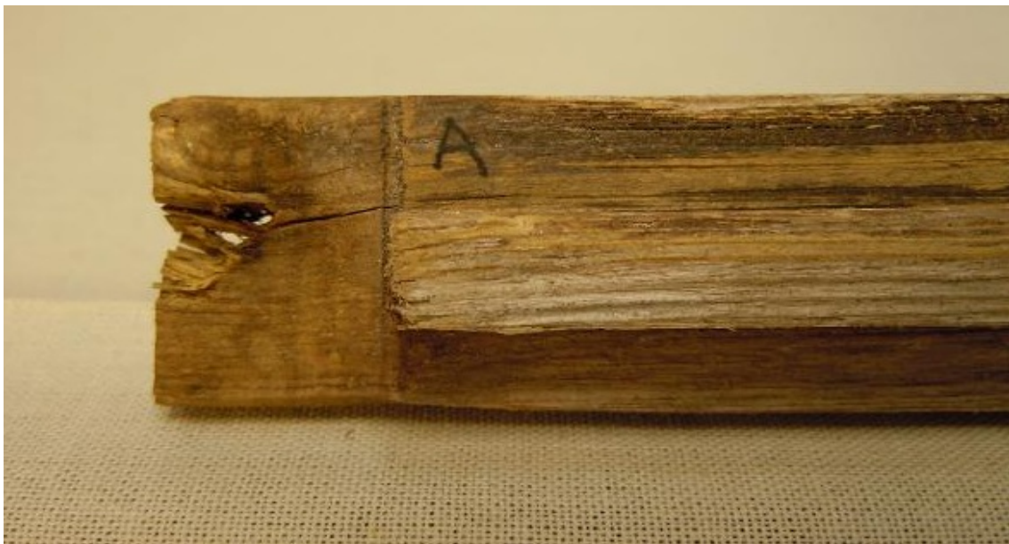
Figur 72 Tappskada på tvärgående spröjs på grund av rostig spik.
