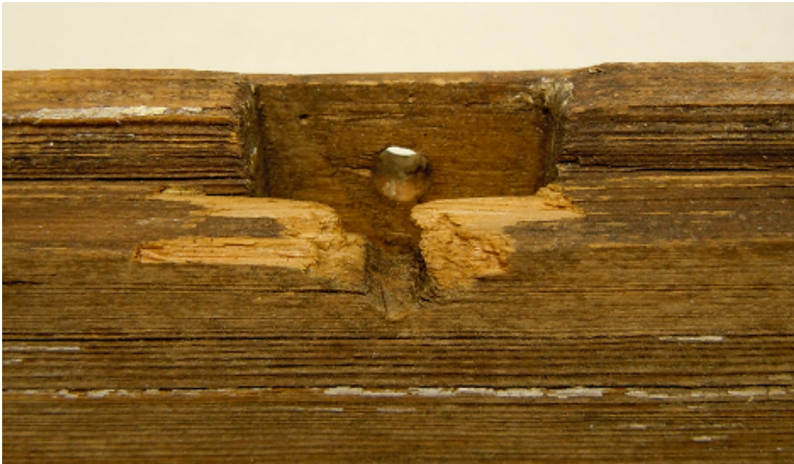
Figur 29 Skada vid sidobågens spröjstapphål.
