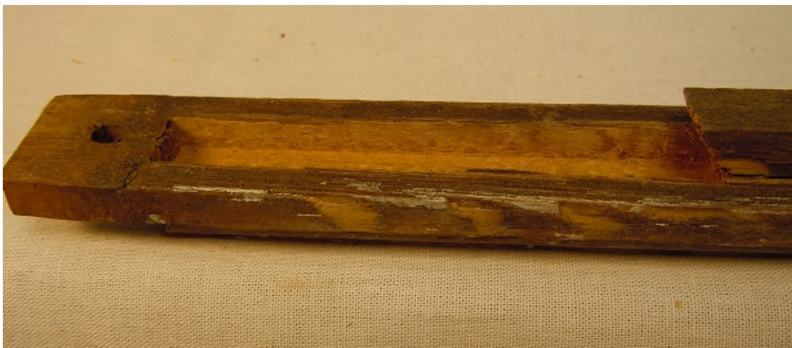
Figur 35 Skadad del avlägsnad. I detta exempel försänks den nya lagningsbiten 5 mm ner i spröjsen. Skarven är även snedskuren.
