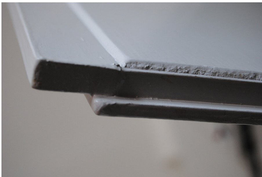
Fig. 29. Detalj av skåplucka klädd med masonit. Luckan består med största sannolikhet av ett ramverk av trä med antingen stödjande lister eller kartong invändigt för att förhindra att masonitskivan sviktar.
