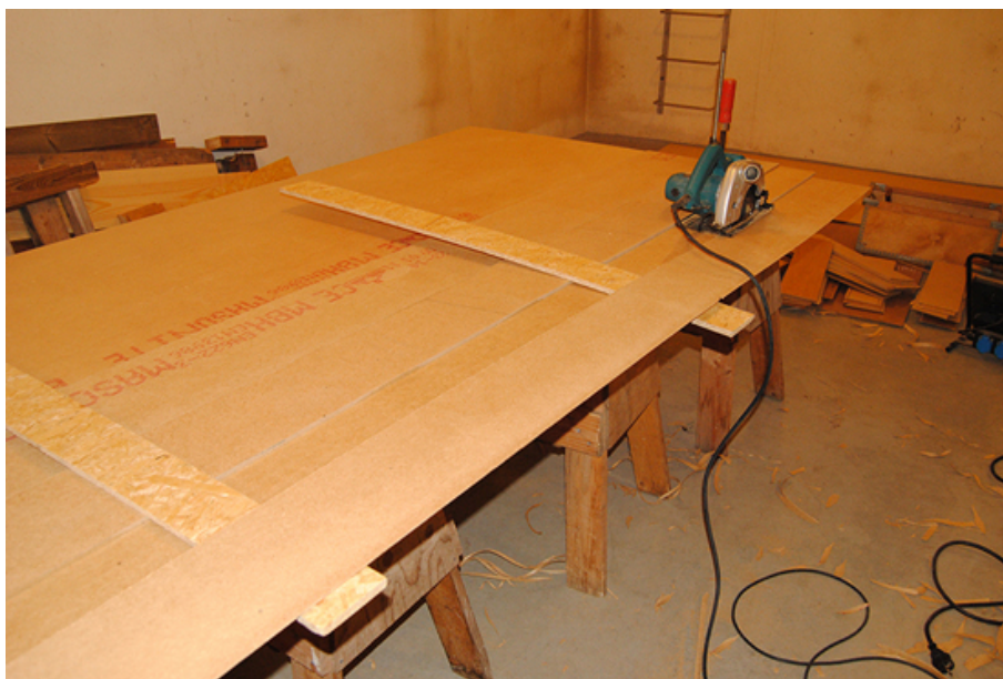
Fig. 67. På inrådan av Bengt-Arne Cramby kunde brädor successivt placeras under avkapet för att undvika att fogsvansen nyper. Det fungerade lika bra för att motverka att cirkelsågen skulle nypa eller kasta. Sågen måste naturligtvis stängas av när detta görs.
