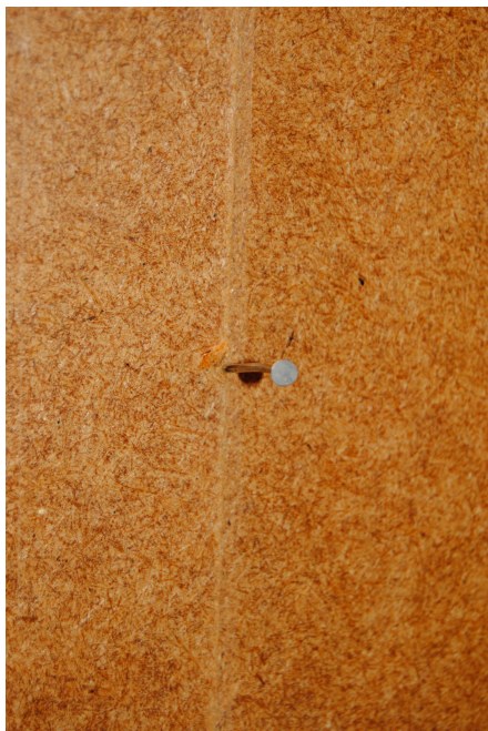
Fig. 81. På inrådan av Nils-Eric Anderson sattes spikar i fasningen på den först monterade skivan. På så sätt fick den andra skivan ett stopp vid monteringen. Enligt honom har de små styrklotsar som beskrivs i fig. 9, avsnitt 3.1.3 aldrig använts utan är ett påhitt från fabrikanten (Anderson 2011-05-18). Den tunna kanten som åstadkommits vid hyvlingen av dolda fogar gick dock sönder när den stöttes emot spiken. Därför monterades resten av skivorna utan stopp vilket fungerade.
