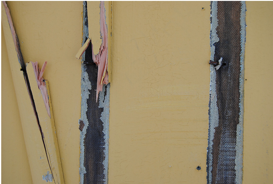
Fig. 37. Trasig läkt på Rundviks skola. Här syns att skivorna varit mer illa där de varit oskyddade. En fördel kan vara att måla skivorna innan läkten sätts upp.
