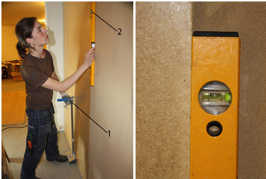
Fig. 76. För att montera skivan i lod användes vattenpass. 1: Staven lossas. 2: När vattenpasset är i lod fixeras staven mot skivan. Vattenpasset kunde även användas för att dra raka spiklinjer med sedan skivan monterats på vägg. Foto: Linda Andersson.
