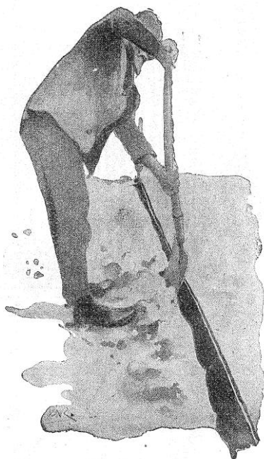
Skarp kant vid varje gång.
