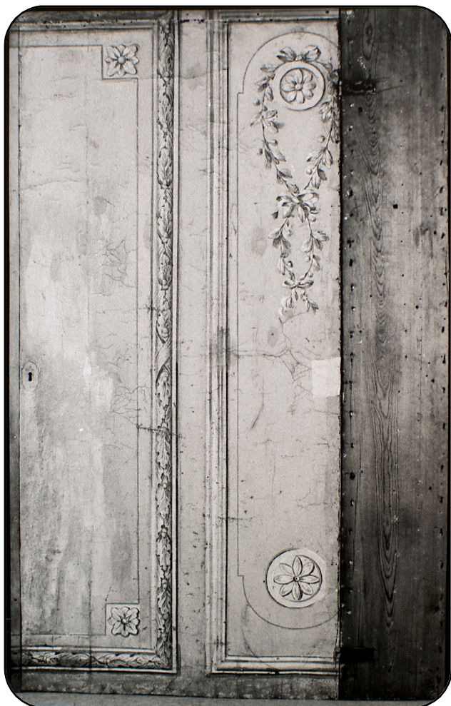
Fig. 2: Tapetvåd på skåpsdörr, före konservering, 1998
