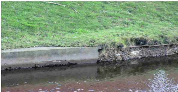
Bild 10. Här har man använts sig av betong och armeringsjärn. Dock har denna börjat vittra sönder.
