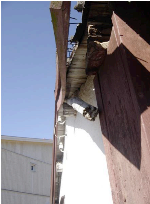
Tak och foder har lossnat.
