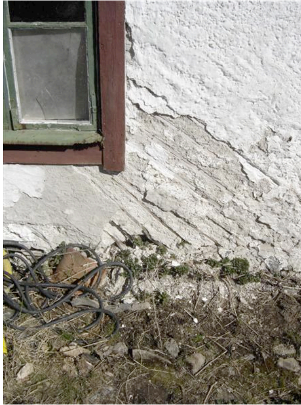
Reveteringen har lossnat.
