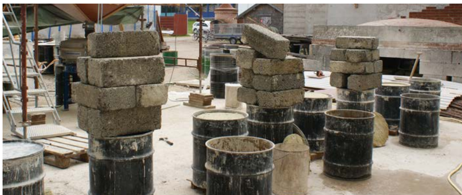
Släckningsstationen under pågående släckningsarbete.
