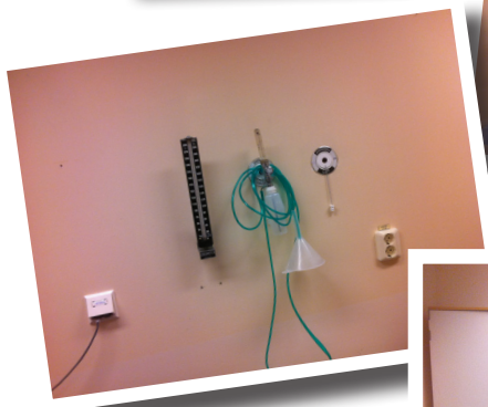
Syrgas från väggen.
