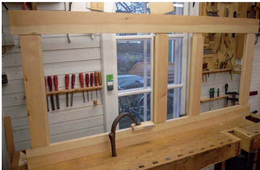
Bild 178. Ramen sätts ihop för märkning vid sidan om tvärstyckena. Från märket dras sedan geringritsen.
