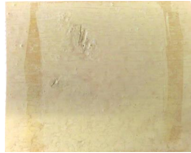
Figur 5: Provyta 3H efter behandling. Exempelbild på fukt som vandrat utanför den isolerande filmen.
