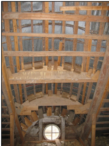
Bild 14. Tryde sn. Sälshög gamlegård. Homejans takkonstruktion har blivit förstärkt av två moderna ramar på insidan som stöttar uppståndarna. Förändringen har troligen gjorts i samband med bytet från stråttak till plåttak.
