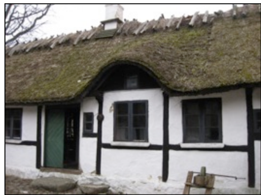
Bild 40. Tomelilla sn. Tomelilla byagård 2011. Takfallet är relativt kort och även om homejans öppning är låg så går uppståndarna nästan ändå upp. Uppståndaren i mitten ansluter till taket på läkt 12 av 17.
