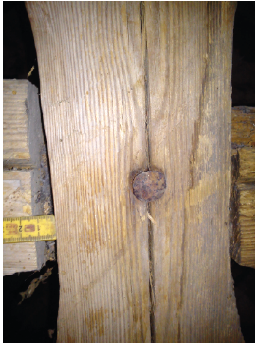
Figur 15 Glipa i möte mellan två stödben
