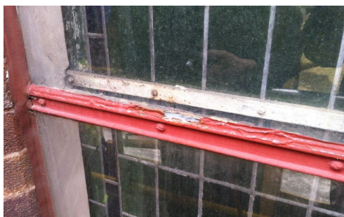
Figur 31. Korrosionsskada på stålpröjs p.g.a. skadad toppförsegling.
