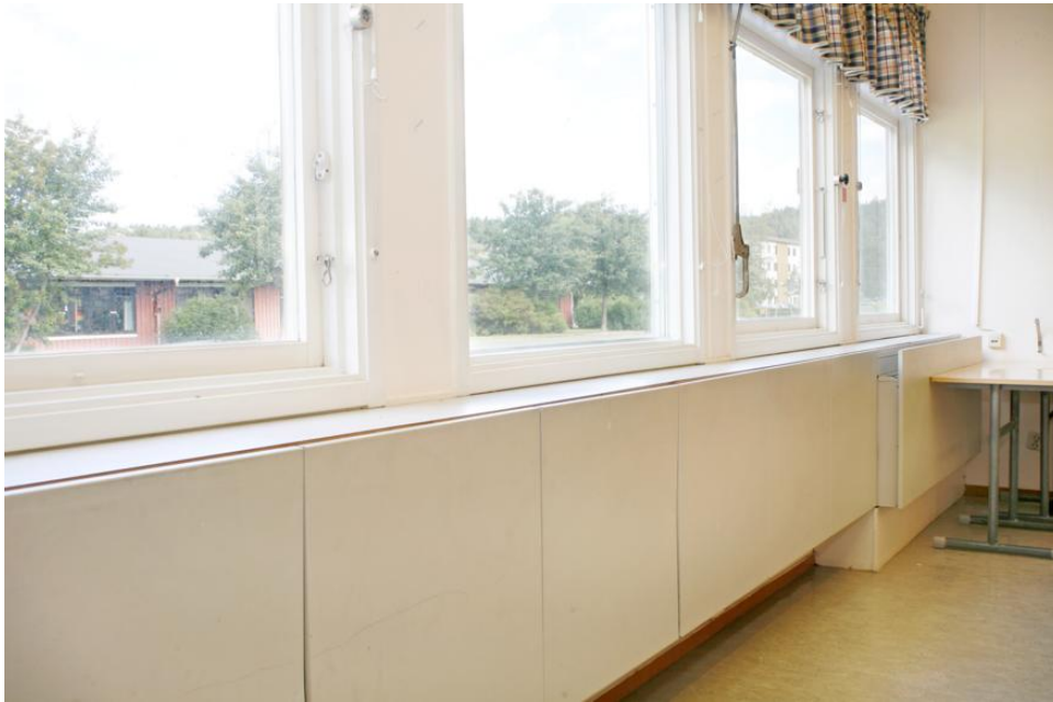
Klassrum före åtgärder: De gamla skolapparaterna som var avsedda att ge värme och ventilation hade slutat fungera
