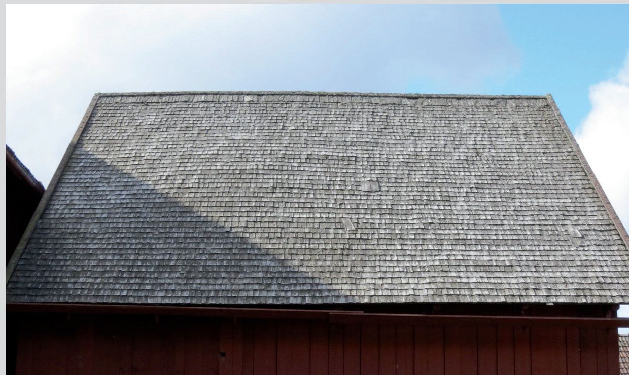
Figur 3.17. Taket före omläggning. Lägga märke till att taket har lappats mitt på taket.
