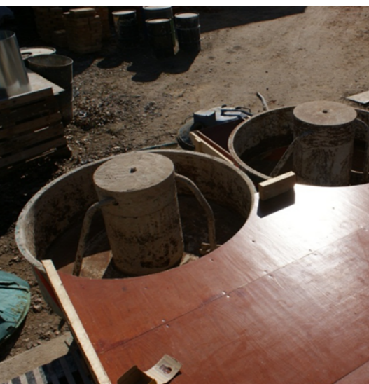
Fig. 73. Ovanpå ställningen finns ett plan av plywood med sargar byggd. Planet ansluter i samma höjd som blandarnas ovankanter. På planet kan kalken sönderdelas i mindre bitar. Kalk som ramlar ut när locket tas av kan samlas ihop och skottas ner i blandarna.
