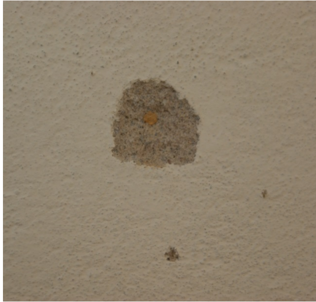
Fig. 13. Mariestad, murhuset. Kalkblåsor visar sig först som en blåsa eller upphöjning på putsens yta. Efter en tid faller sedan en liten bit av putsens yta av och efterlämnar skador i form av små kratrar. I kraterns mitt syns ett brunt korn. Kornet var vid putsningstillfället osläckt. Kornet har sedan putsen färdigställts släckts och expanderat där av skadan. Kalken som putsen innehåller är en ren luftkalk bränd vid 1400°C. Kalken släckts som en del i undervisningen vid bygghantverksprogrammet och används i de dagliga puts och murövningarna.
