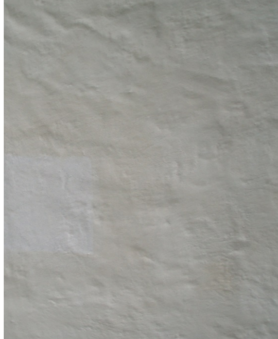
Fig. 6. Gillstad kyrka, sakristians östra hörn. Av bilden framgår att den ursprungliga putsens yta framträder genom det tunna skikt av bruk som borstats ut ovanpå den befintliga putsen. Av resultatet framgår att bruket som borstat in inte uppfattas som en överlagrad textur på den underligande putsens uttryck.
