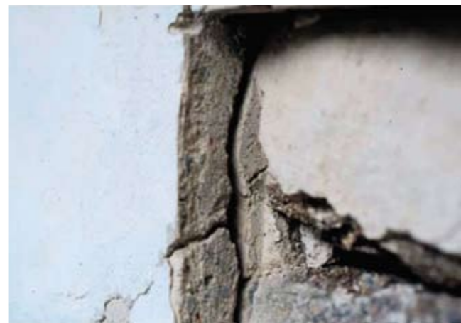
Bild 5. Detalj av putsen på Gillstad kyrka. Vidhäftningsbrottet mellan medeltida originalputs och putsrenovering från 1600-talet. Bilden illustrerar hur hård 1600-talsputsen är. Den står som en i stora partier självbärande skiva på den gamla putsen.
