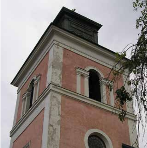
Det av väder och vind utsatta tornet på Barkeryds kyrka före ommålning 2008. Fasaden var då sedan 1964 målade med vattenglasfärg och KC med silikat tillsats. Fasaden i övrigt var inte så här eroderad. Foto: Arja Källbom.
