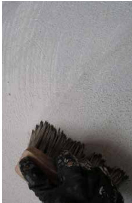
Lasering av murstocken i syfte att få en levade och kontrastrik yta.
