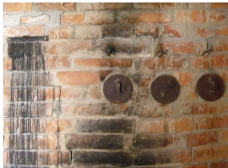
Rökkanalernas sotluckor och spjäll
