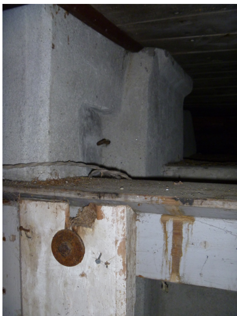
Murpannans rökgång och spjäll
