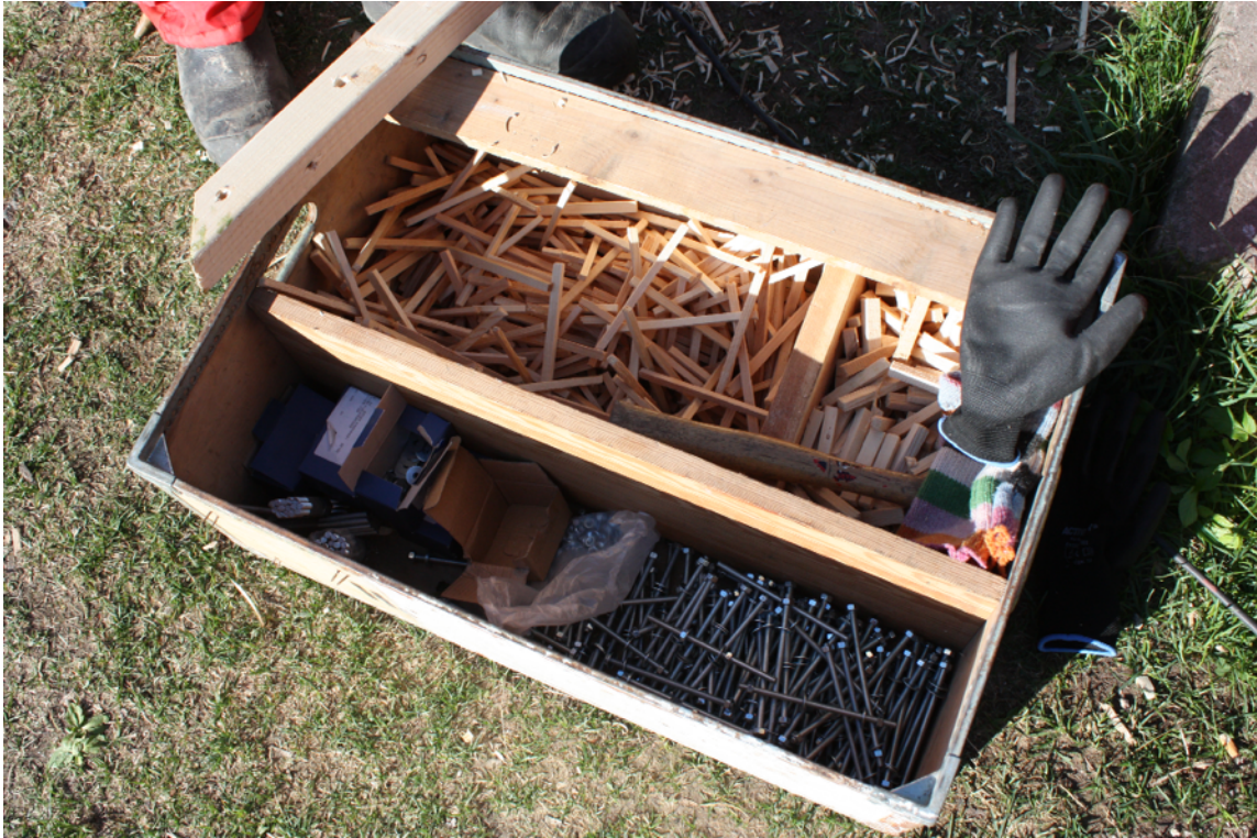
Figur 20. En låda med bultarna och träplugg i två olika storlekar. Gängstångerna, muttrarna och brickorna jag valde var blankförzinkade, detta utav enda anledningen att de var något billigare än de galvaniserade som var tanken att de skulle användas. Att välja bult i syrafast utförande skulle bli för kostsamt. Dessa sattes samman tio och tio med vävtejp och kapades med tigersågsblad i längder om 130 mm. Detta för att få så lite grader som möjligt så muttrarna skulle gå att skruva på. Anledningen att jag valde gängstång att kapa själv var att jag kunde få ner priset per bult med muttrar och bricka till 1,50 kr. Själva kapningen skulle amatören klara av. Det gick inte att hitta en M6 vagnsbult som var 130mm något som hade varit optimalt.. Foto: Gunnar Almevik
