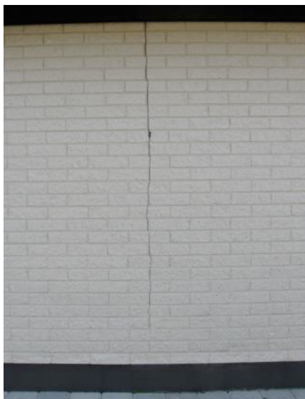
Exempel på genomgående spricka där bruket är starkare än fogen.
