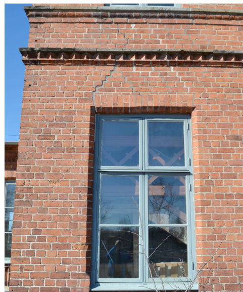
Exempel på spricka som följer fogen därför att bruket är svagare än stenen.
