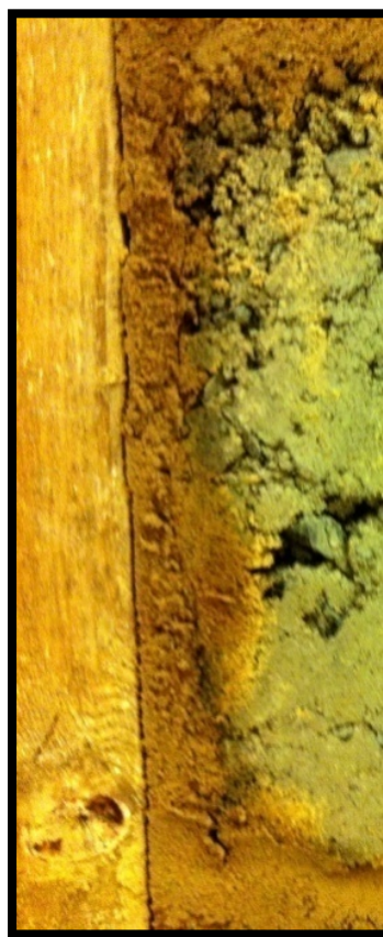
Figur 20. Sprickbildning i fog mellan block och stolpe.
