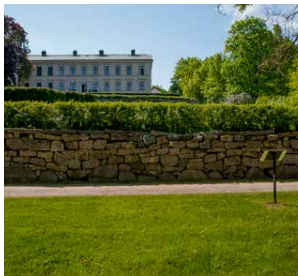
Det skadade partiet på stödmuren med herrgårdsbyggnaden i bakgrunden. Foto: Bertil Lindgren
