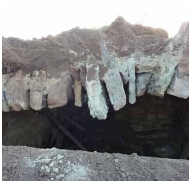
Skador på valvet.
