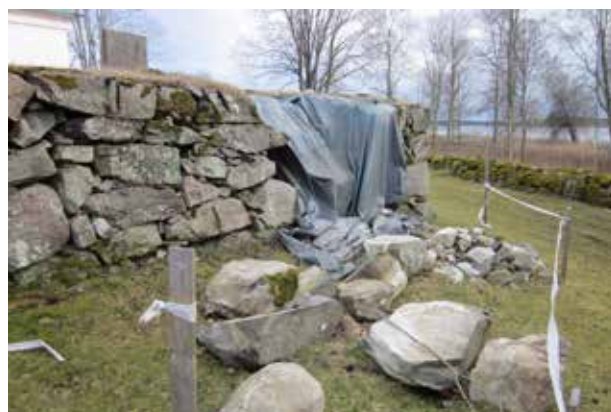
Skador på stödmur. Ramundeboda klosterruin, Örebro.
