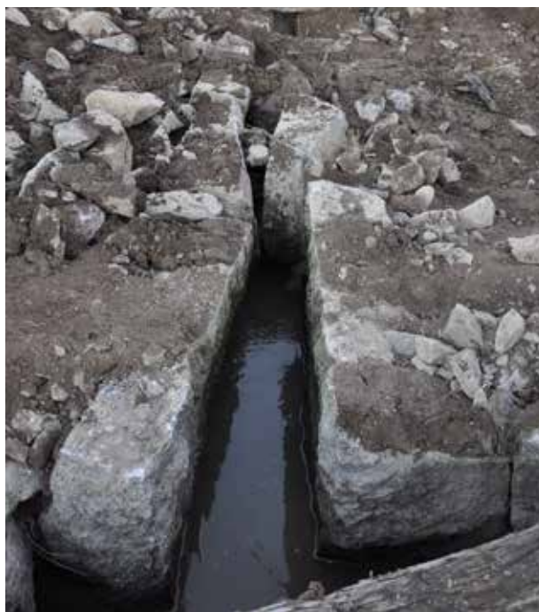
När balkarna lyfts av blev det tydligt att sidomurarna tryckts ihop och orsakat stopp i trumman.
