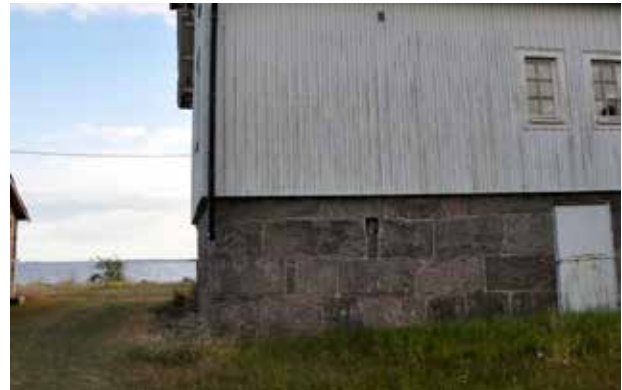
Källarväggar kan vara fyllda med sten, jord eller murbruk, och tätade med kalkbruk i fogarna. Lotsgården, Revsudden, Småland.
