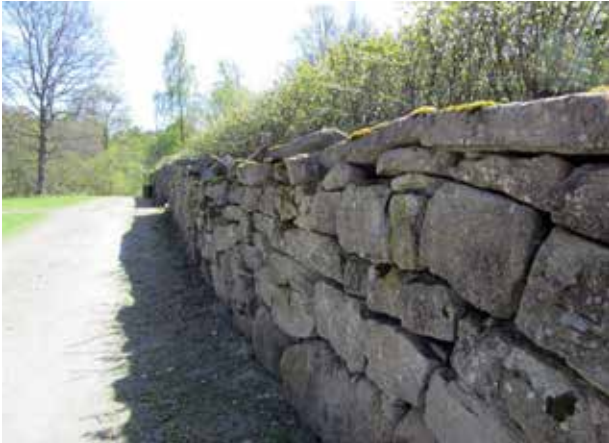
Muren har kalvat och buktar kraftigt. Foto: Monica Christensen.
