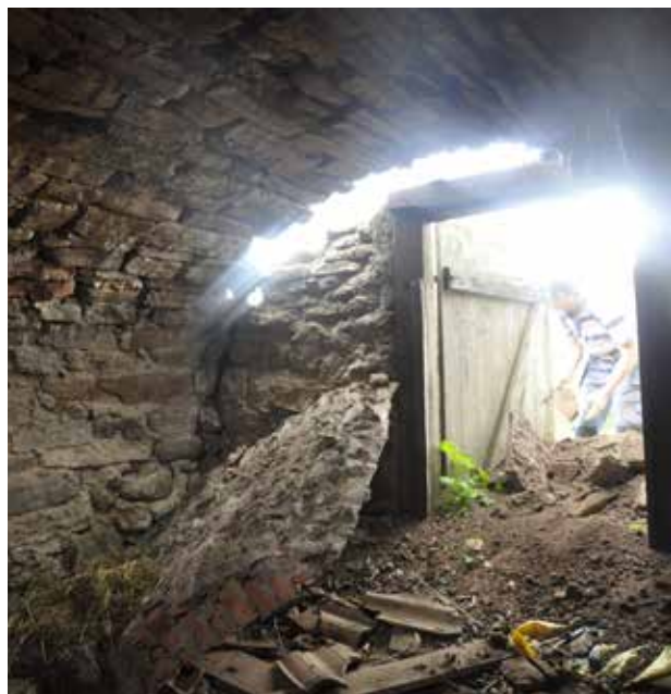
Frontmuren var skadad och hade delvis rasat.
