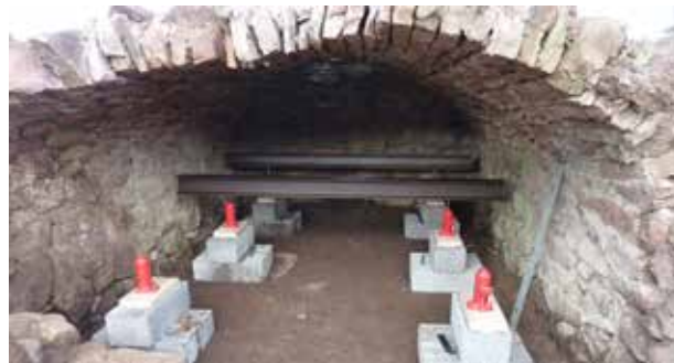
Valvställningens underrede med domkrafter och balkar.
