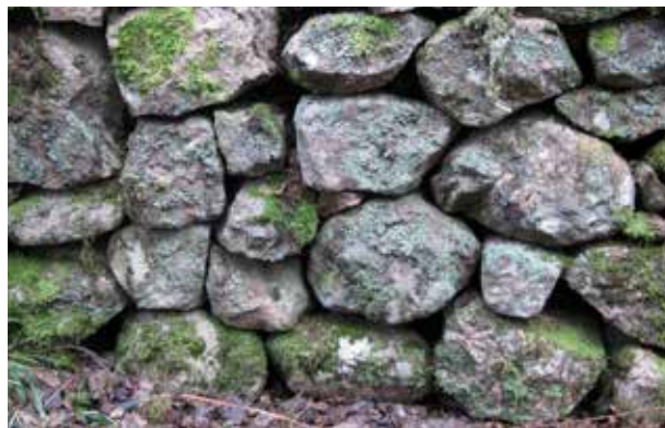
I ojämn skiftgång skapas ojämn skift. Vinklar och fack ska passa materialet. En stor sten kan byggas ikapp med mindre. Törnbergavägen, Mariestad, Västergötland.
