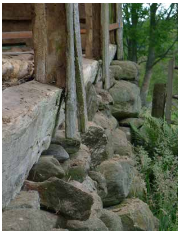
Skador på syll och stenfot.
