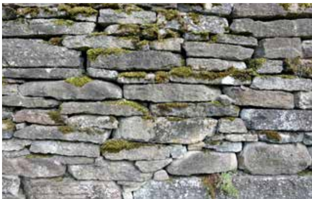
I jämn skiftgång skapas platta skift. Inpassare används för att få upp en något tunnare sten till rätt nivå. Ett skift kan byta tjocklek med ett språng. Kungslena kyrka, Västergötland.
