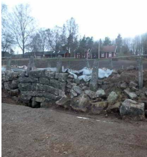
Sidomurarna var i dåligt skick.
