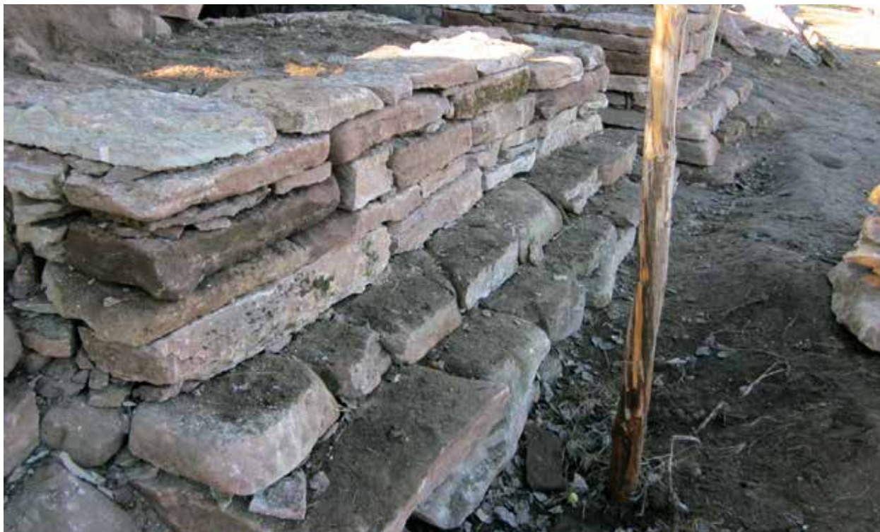
Dubbel murfot på jordfylld skalmur. Hela murfoten hamnar under marknivå och blir inte synlig i den färdiga muren. Ambjörntorp, Gudhem, Västergötland.
