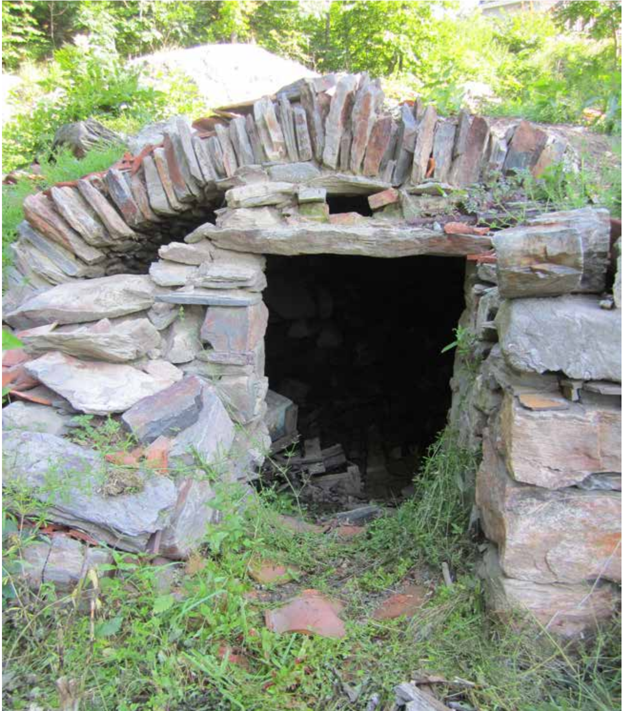
Jordkällare där fronten rasat. Valvet står fortfarande intakt. Rösselvik, Bohuslän.
