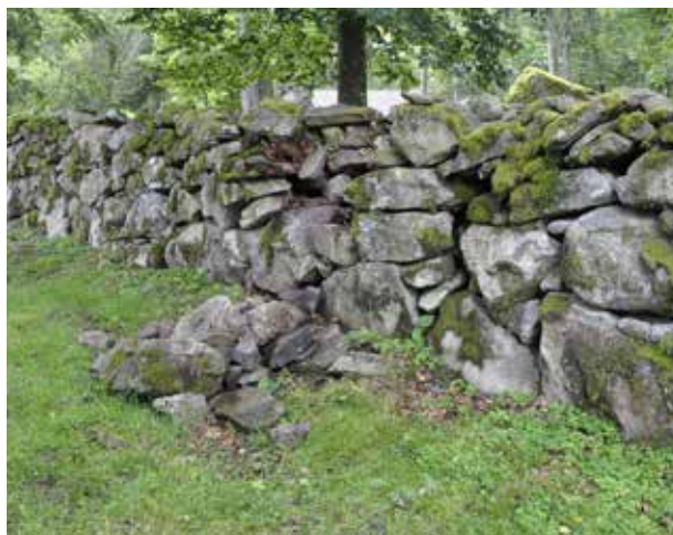
Det rasade partiet som skulle restaureras.
