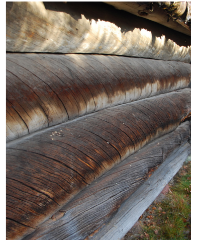
Figur 2.4. Extremt växtvriden ytterved i ett småfåhus som tillhört en fåbod i Älvdalen. Man hade traditionellt kunskap om att den här typen av virke var mycket rötbeständigt och det går att se i många fler byggnader att det används i bottenvarven på fåhus, i syllramar och mushyllor under härbren. Jon Godal benämner detta "aldersved" (Godal 2012).
