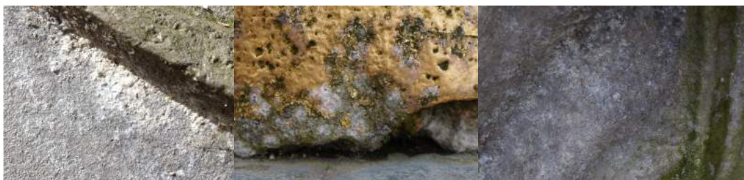
Fig. 15. Detaljbild på korrosionsprodukter på verk 6.
