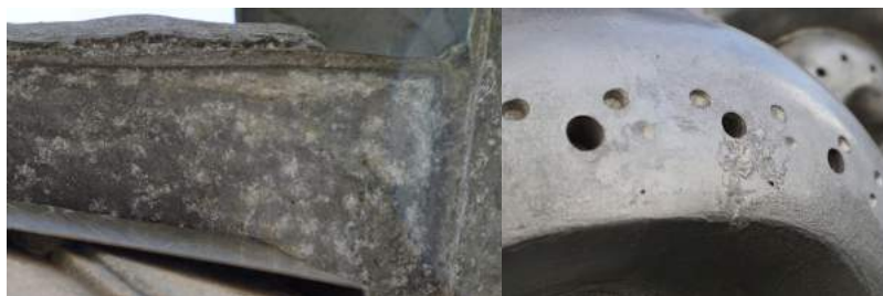
Fig. 19. Verk 2 och 13 med vit korrosion.
