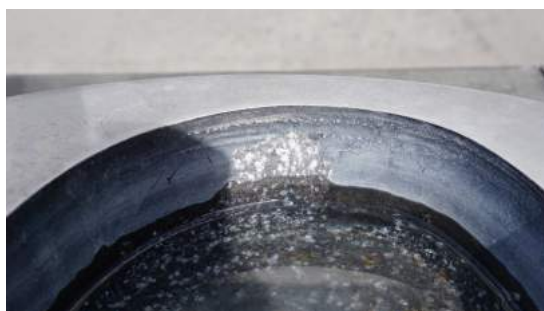
Fig. 29. Vattenansamling i en av bokstäverna i verk 17.
