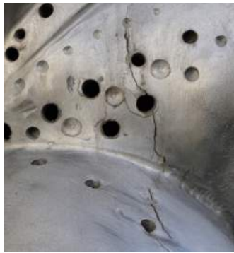
Fig. 30. Sprickbildning i verk 13.
