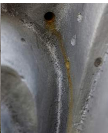
Fig. 23. Rinningar av rost på verk 13.
