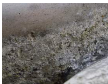
Fig. 14. Detaljbild av verk 1, som visar bildad vit korrosion på ytan.
