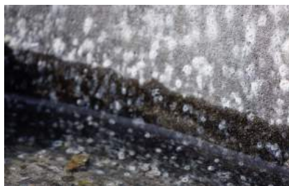
Fig. 18. Fläckvis korrosion och vattenansamling i verk 17.
