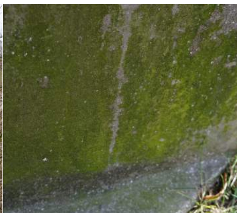
Fig. 12. Detaljbild på verk 6 med biologisk påväxt.
