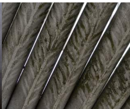
Fig. 21. Ljusa rinningar och biologisk påväxt på undersidan av verk 4.
