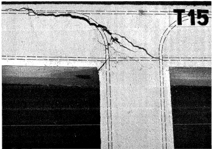
FIG. 5 T-knut efter diagonalsprickbrott orsakat av böjande moment. Armeringen inritad.
