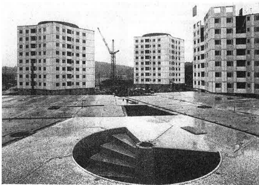
Fig. 6. Göteborgsbostädernas senaste system använt för stjärnhus i åtta våningar i Västra Frölunda i Göteborg; i förgrunden en del av ett trapphus med bjälklags- och trapphuselement synliga.
