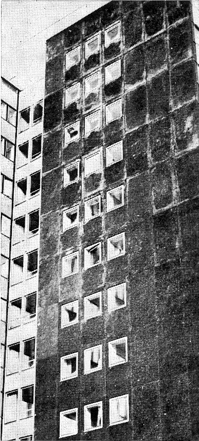
Fig. 1. Kondensation av fukt i husfasad.
