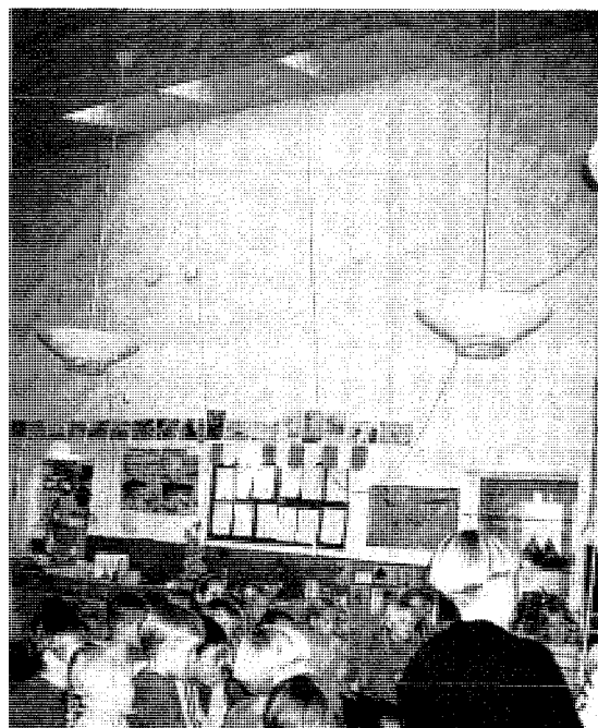
Tilluftsdonen sitter nära lanterninfönstren, som ska evakuera frånluften - finns risk för kortslutning av luften? Den något svalare tilluften skall, enligt beräkningarna, sjunka ner till vistelsezonen.
