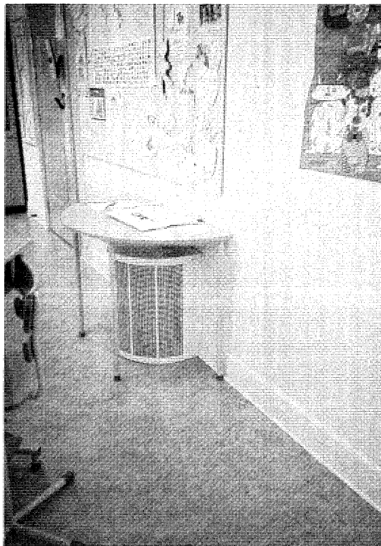
Tilluftsdonen är deplacerande och eftersom tilluftskanalen ansluter underifrån har donets ovansida kunnat förses med ett litet avlastningsbord.
