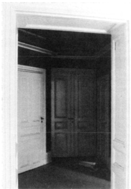
FIG 3.93 List "tar ner" takhöjden. Undertak skall monteras dikt an mot pardörrens foder
