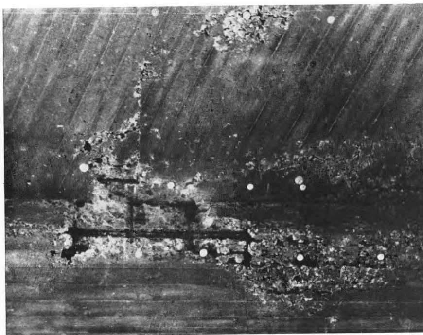
Exempel på gjutsador som efter formrivning konstaterades på undersidan av en vägport och som reparerades i enlighet med den i rapporten angivna metoden.
