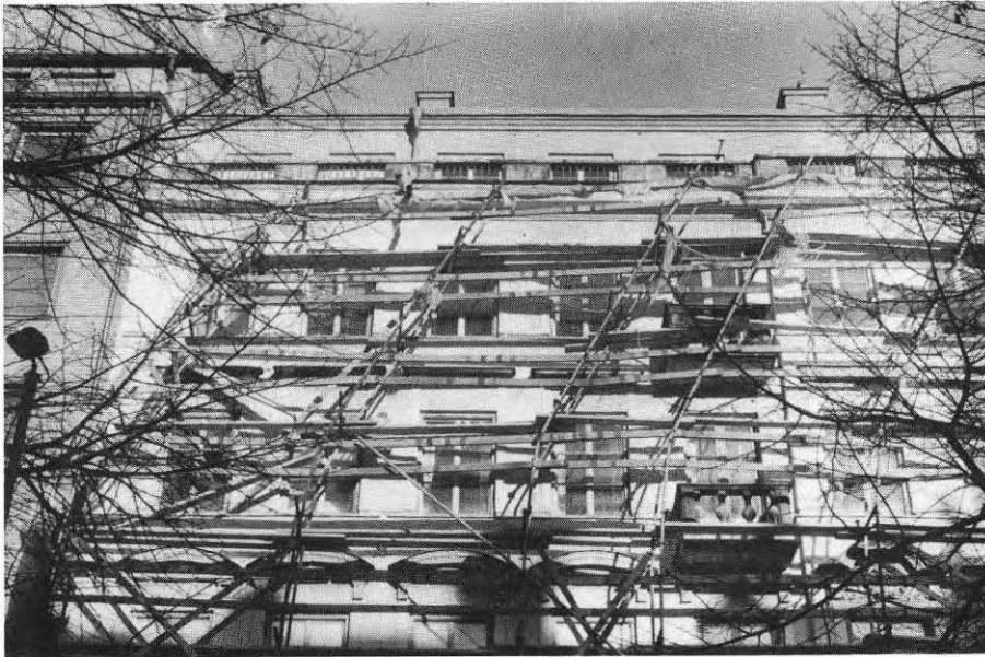
FIG. 5.2.1 Rörställning, som varit otillräckligt förankrad, efter stormen.
