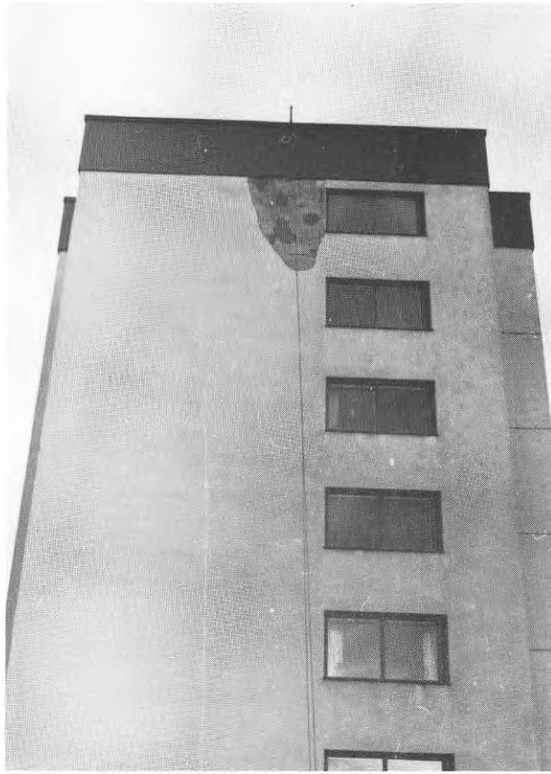
FIG. 4.3.1 Putsskada på vägg parallell med vindriktningen.
