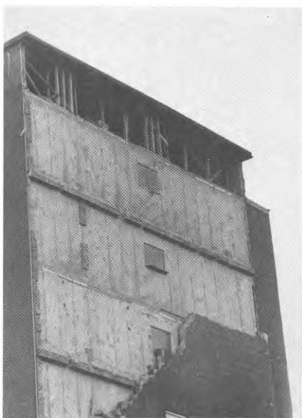
FIG. 4. Skada på skalmur av lättbetong.
