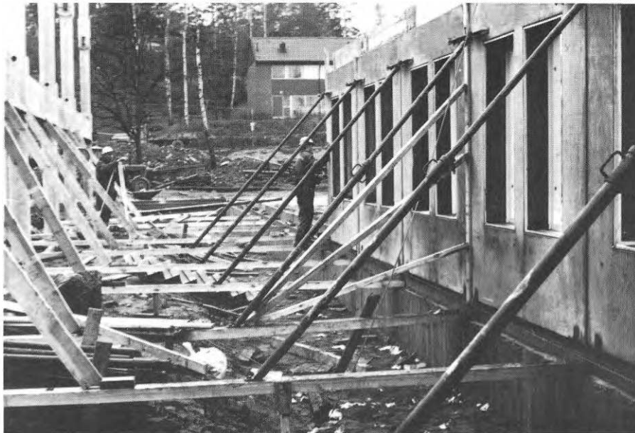
FIG. 24 d. Förankring av stag i provisoriska träreglar. Anchorage of ties in temporary studs.
