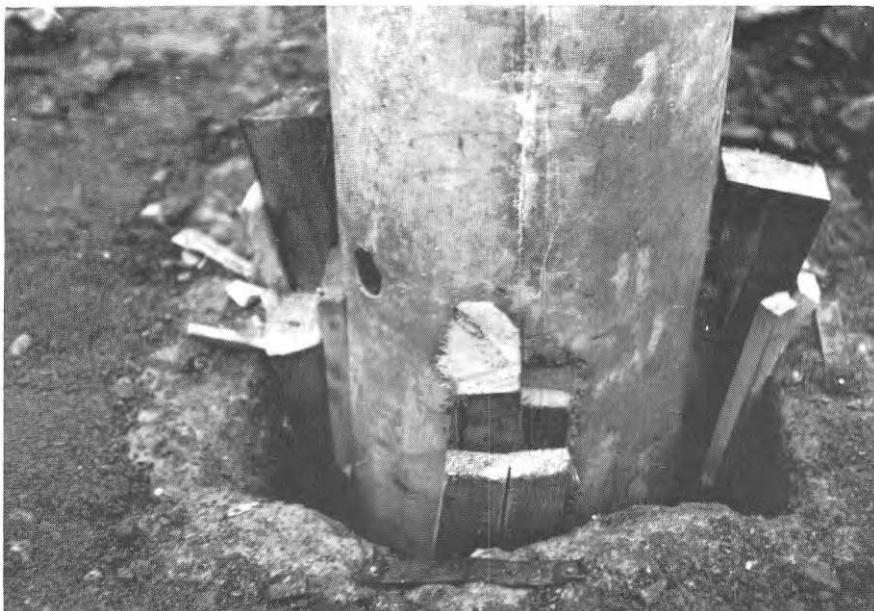
FIG. 22 d. Fastkilning av pelare före holkjutning. Wedges round column before casting of socket.
