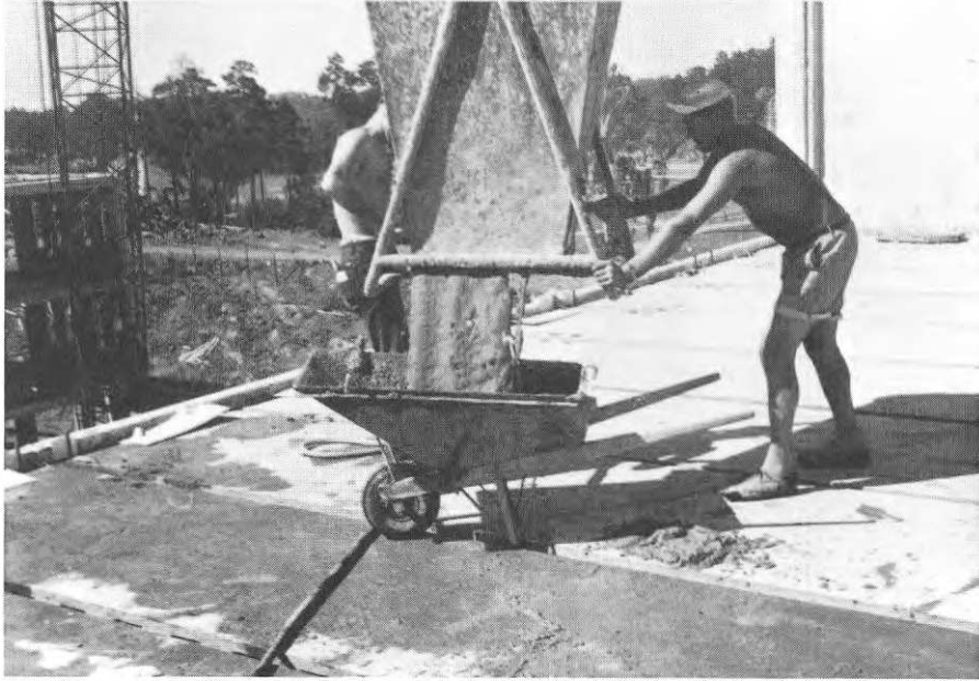
FIG. 40. Fogbruk fylles i kärria för utkörning på valv. Slurry being loaded into barrow before wheeling out onto floor.
