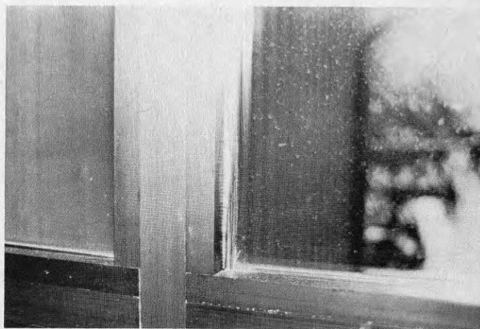
Foto nr 8. Stora fogrörelser i mörkanodiserad alumi- niumkonstruktion.
