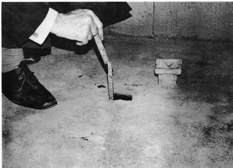
Fig. 8. Observationsrör i golv för kontroll av vattennivån.
