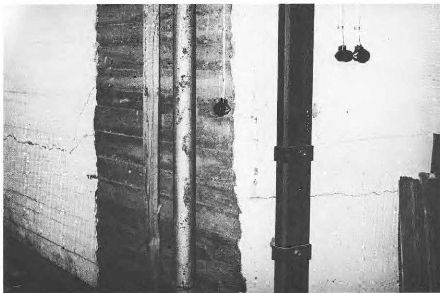
Fig. 18. Källaryttervägg i Österängsskolan som förstärkts med stålprofiler mot jordtrycket.
