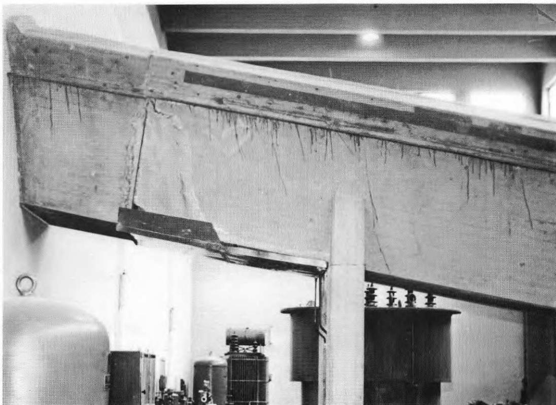
Fig. 16. Timmerränna i Hissmofors kraftverk skadad av skiffersvällning. På undersidan plåt för läckvatten.
