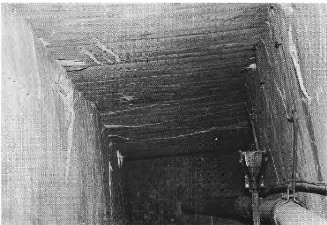
Fig. 17. Skadad varmluftskanal med arean 1 \text{ m}^2 i Hissmofors kraftverk.
