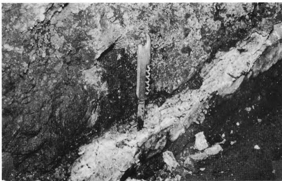
Fig. 3. Skadad betongkant vid golv i anslutning till skiffervägg i Hissmofors kraftverk.
