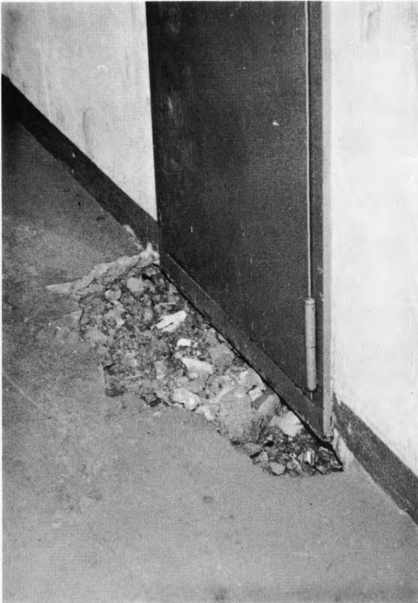
Fig. 13. Uppsmejslat betonggolv vid källardörr.
