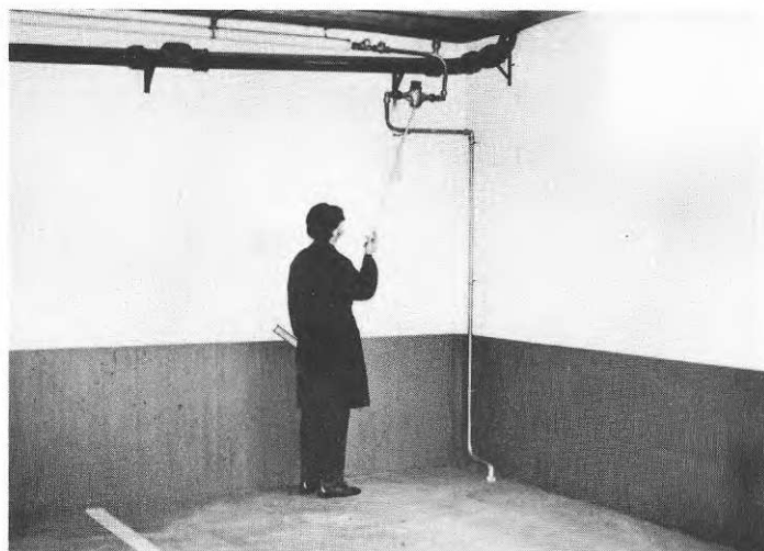
Fig. 7. Påfyllningsrör med särskild vattenmätare.
