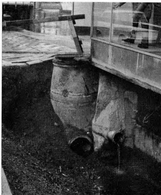
1 Ledningsskador i Huddinge centrum
